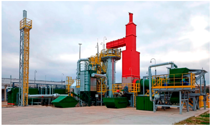
Комплекс термического обезвреживания отходов (КТО).
