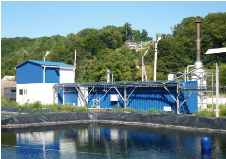
Система очистки стоков (фильтрата) полигона ТКО, г. Адлер
