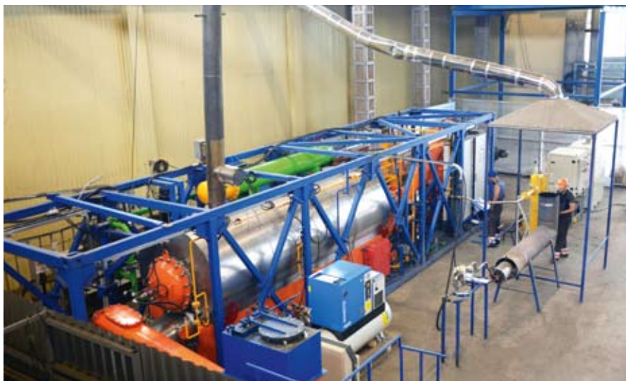
Установка термической деструкции УТД-2-200 с подключенной системой автономной генерации электроэнергии
