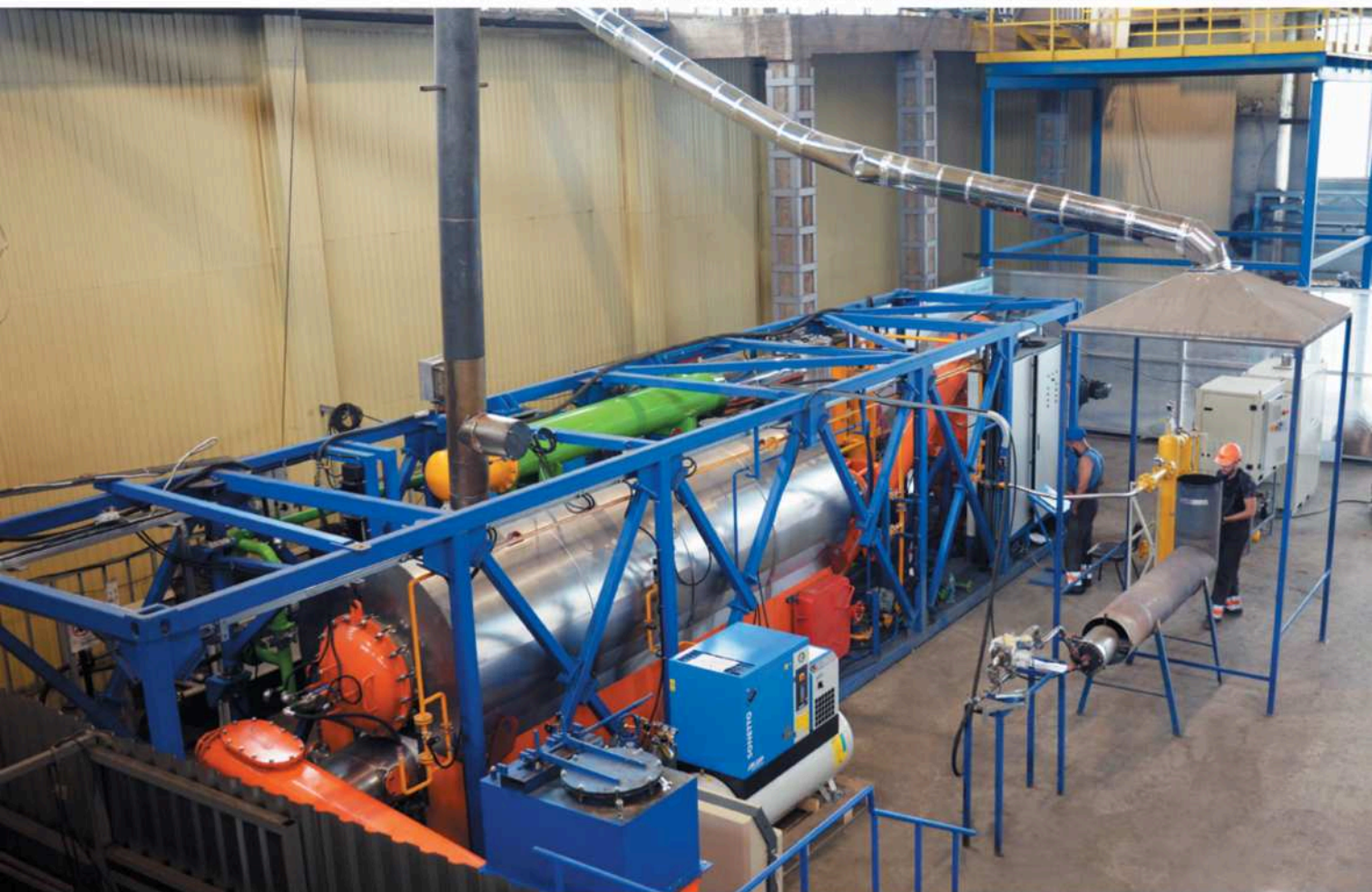
Установка термической деструкции УТД-2-200
