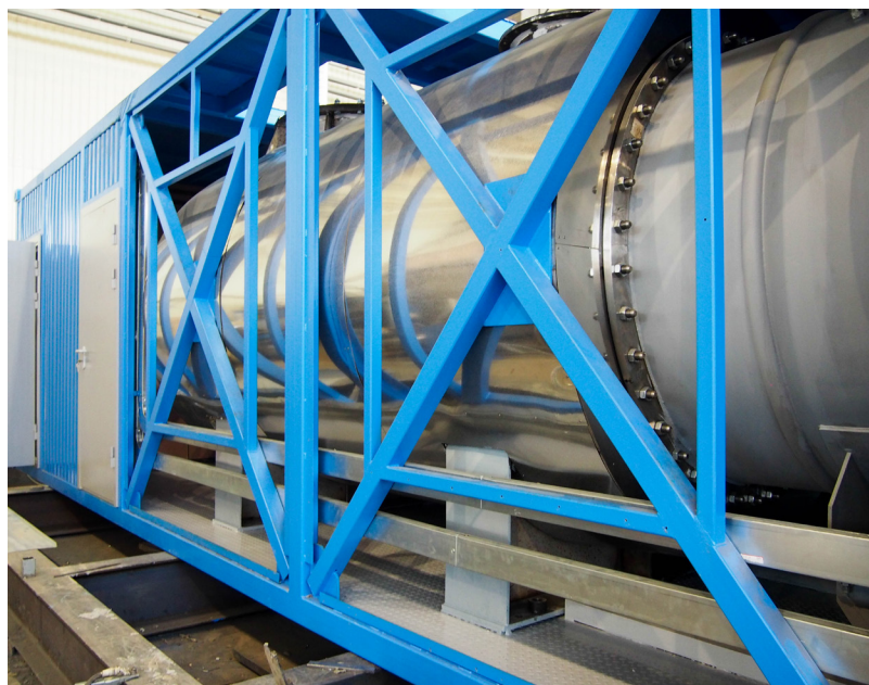
Фото 2 – Комплекс термического обезвреживания стоков КТО-3000.К40.СВ
