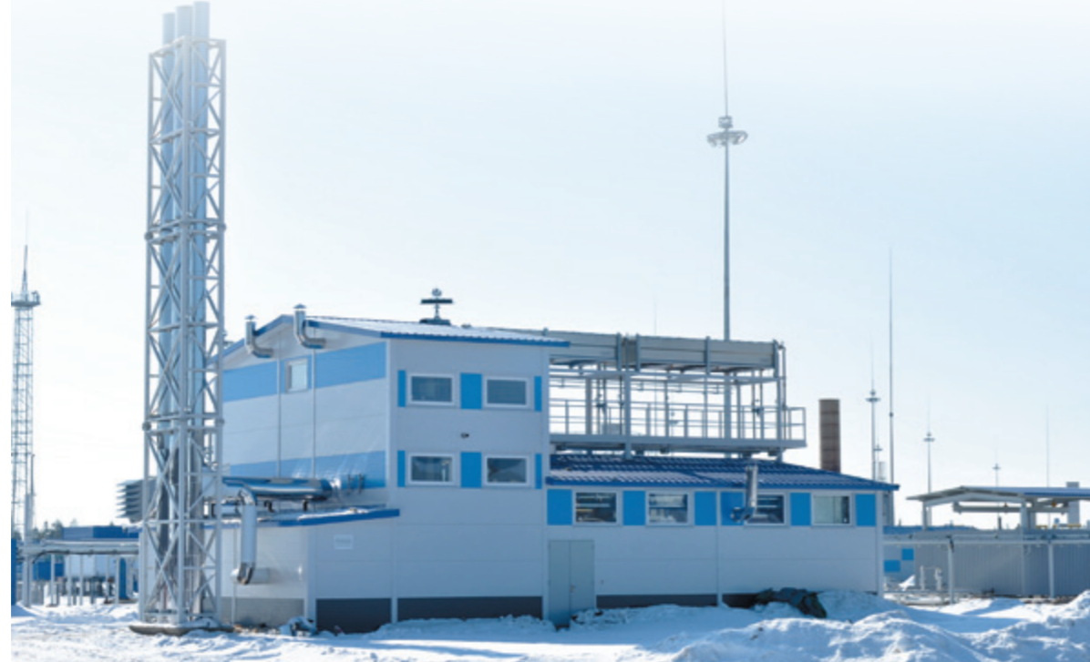
Рис. 1. Комплекс термического обезвреживания КТО-1000.БМ.КСЖ (КС Портовая)
